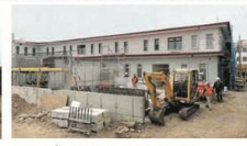
REPOSICIÓN CESFAM EMILIO SHAFRAUSER Las obras del nuevo Centro de Salud Familiar Emilio Shafrauser de La Serena se encuentran en ejecución, y ya tienen un 81% de avance. Costo total de inversión: Más de $8 mil millones
